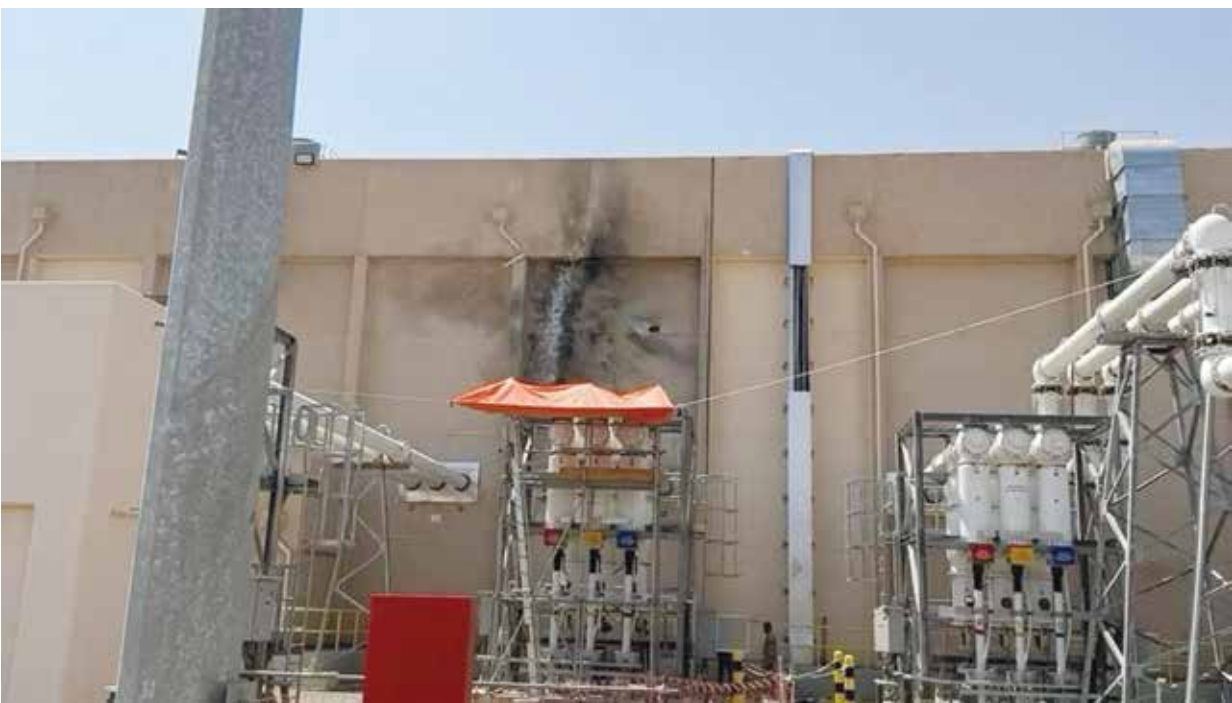
○ آثار الاعتداء الحوثي الإرهابي على محطة الكهرباء التي تزود المسجد النبوي.
